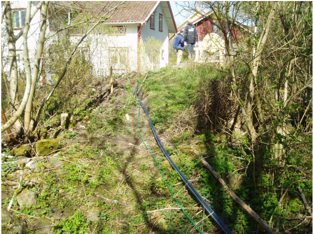
Bild 37. Utanför boningshus 6:4+5:6 Man ser sträckning mot 6:7 tuber ligger i skydds slang.
